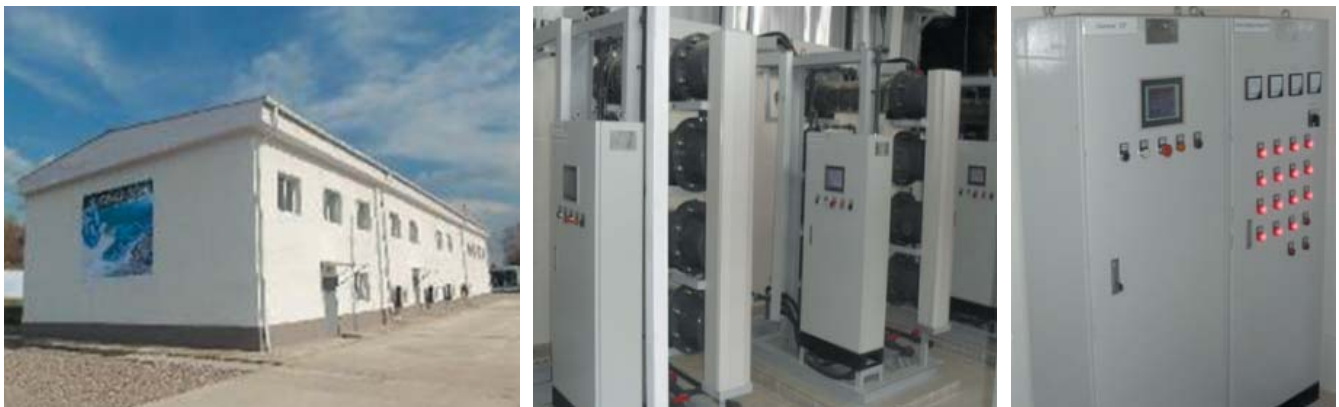
Рис. 3. Самотечная станция ГУП «Душанбеводоканал»
