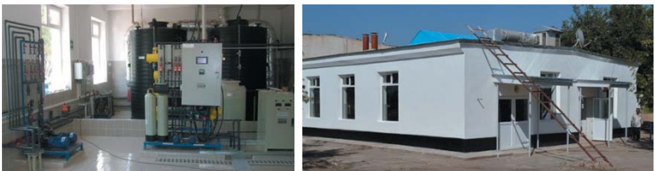
Рис. 4. Водозабор ГУП «Водоканал г. Курган-Тюбе»
