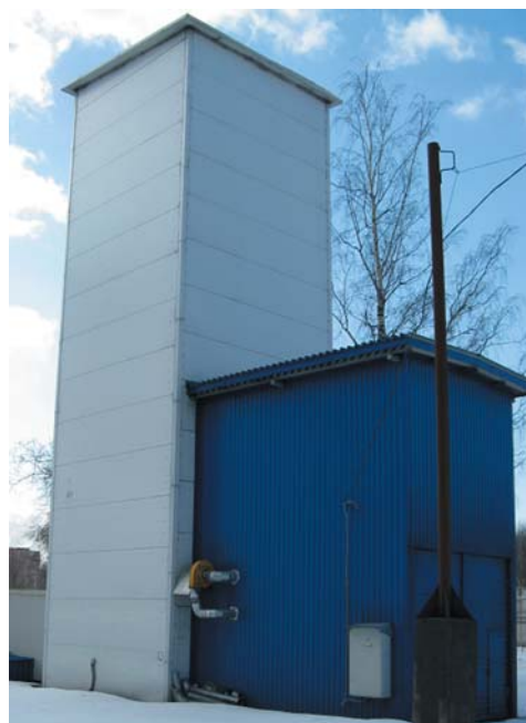
Рис. 1. Установка дозирования ПАУ на Южной водопроводной станции
